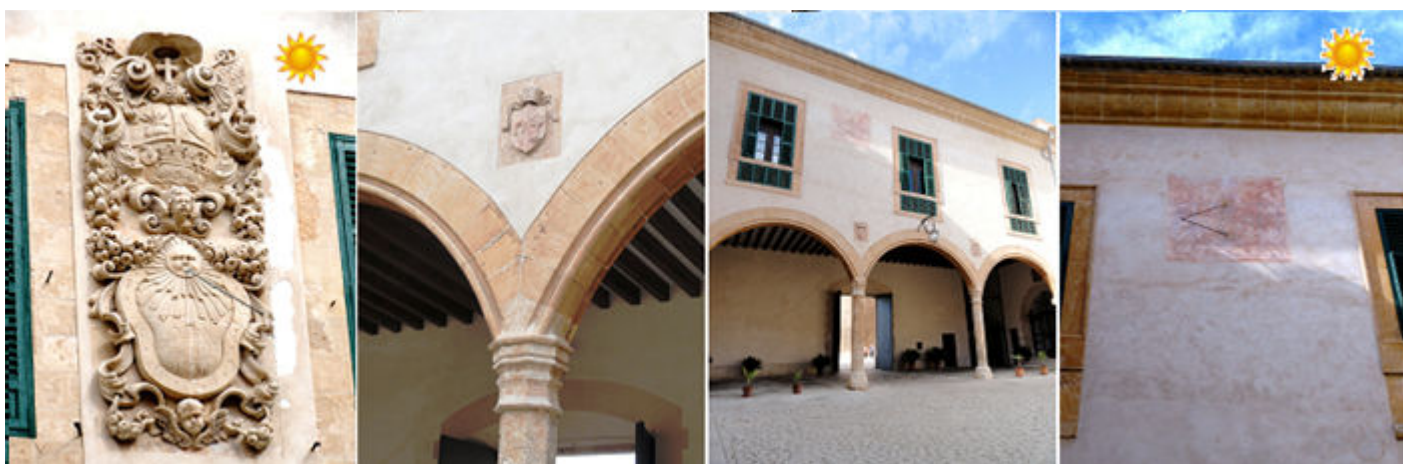
❶ En el patio del Palacio Episcopal, bajo el escudo heráldico. Tipo: vertical, rectangular. Con los números y horas excavados. Orientación poniente. En su parte superior ostenta un sol en relieve. Traza: de las 8,30 a las 7 h. p.m. en números arábigos. Gnomon de varilla. Estado: perfecto. Año: 1734 Obra del Obispo fray Benito Pañelles, reza en su parte inferior ❷ Una de las columnas de los arcos del pórtico. ❸ Situación del segundo reloj. ❹ Este 2ª también del tipo: vertical, rectangular. Con las horas pintadas. Orientación al mediodía Traza: de las 5 a las 1? h. p.m. sin números. Gnomon de varilla con apoyo. Estado: está muy descolorado y se aprecia algún rasgo de pinturas en su parte central.
